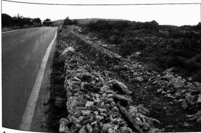
Φωτογραφία από τα έργα διαπλάτυνσης του κεντρικού δρόμου στα Αρωιάδικα. Η παρέμβαση αυτή θα βελτιώσει τις συνθήκες κίνησης των οχημάτων στο συγκεκριμένο σημείο, πολύ κοντά στο χώρο ανέγερσης του νέου Νοσοκομείου.
