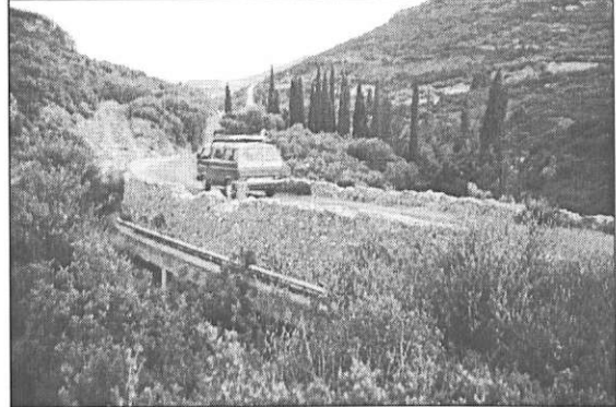
Το γεφύρι στο Πλατανάκι. Διακρίνονται οι επεμβάσεις του ΟΤΕ και της ύδρευσης. Μια διαπλάτνση χρειάζεται τώρα για να καταστραφεί αισθητικά. (Φωτ. Αρχ. «Κ»)
