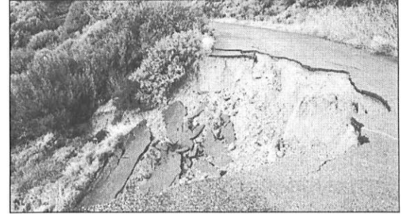
Ένα σημείο στο οποίο η φύση άφησε ένα κομμάτι δρόμου με άσφαλτο... Η ανάγκη αποκατάστασης είναι άμεση. (Φωτ. Γ. Λευθέρης).
