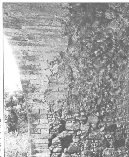
Η καμάρα με βόλο στο γεφύρι Καψαλιού. Διακρίνονται τα σημεία διάβρωσης. (Φωτ. Βασ. Λευθέρης).
