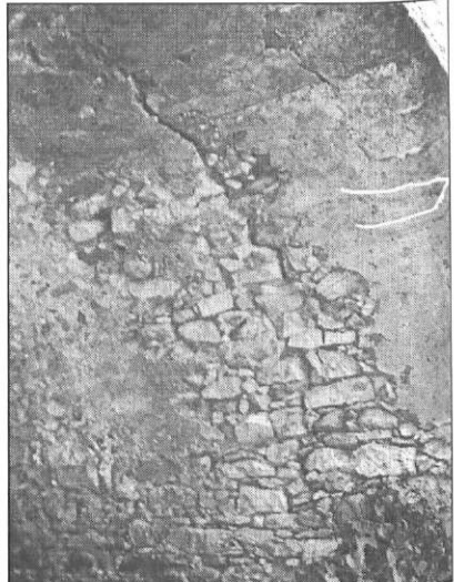
Το γεφύρι στο Πλατανάκι. Διακρίνεται η επικίνδυνη ρωγή στη μέση του τξόου. (Φωτ. Βασ. Λευθέρης)
